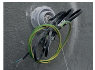
Pool terre installé en dessous du projecteur Pool terre instalado debajo del proyector
